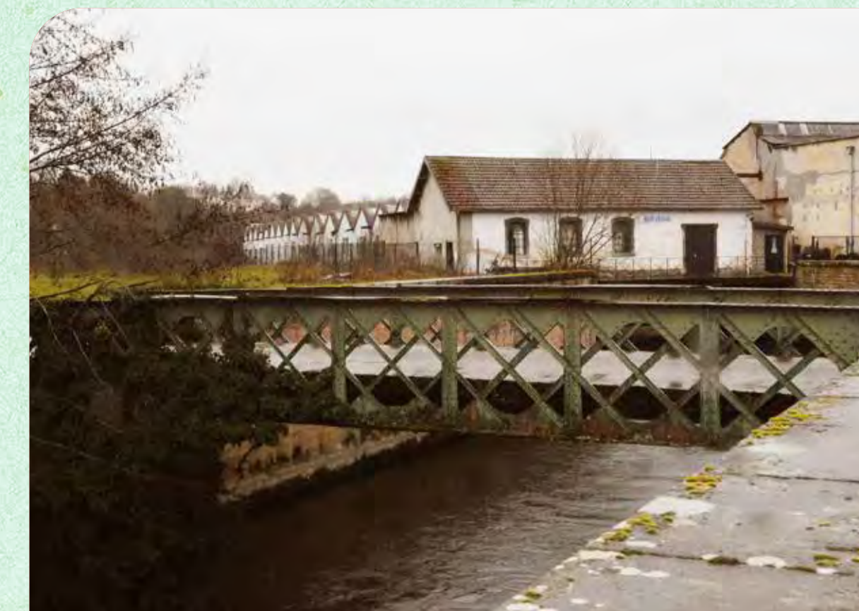
Passerelle Nord AVANT
